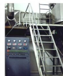
控制系统 Control System
